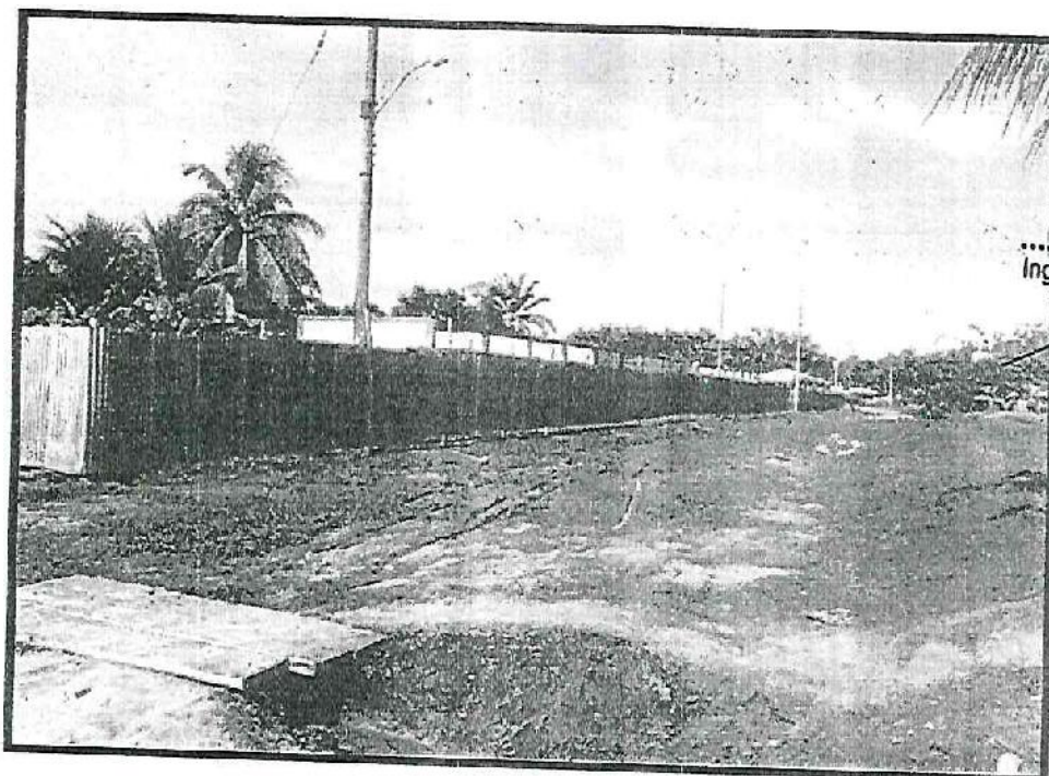
CERCO PERIMETRICO DE SEGURIDAD EN OBRA
